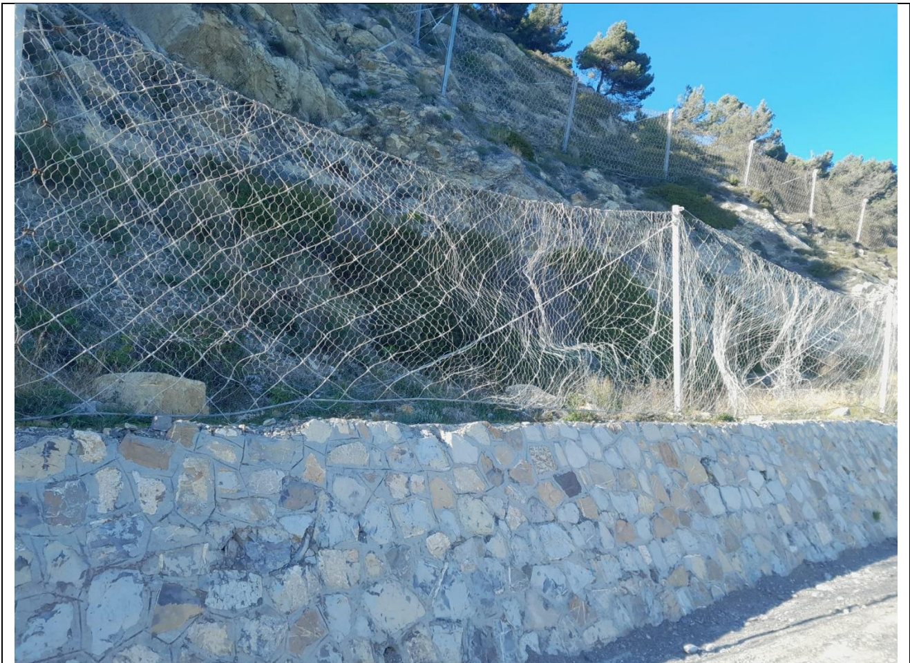
Figura 3 – Barriera esistente posata in sommità al muro (Id BP.I.17), con evidenti problematiche di corretta registrazione e montaggio
