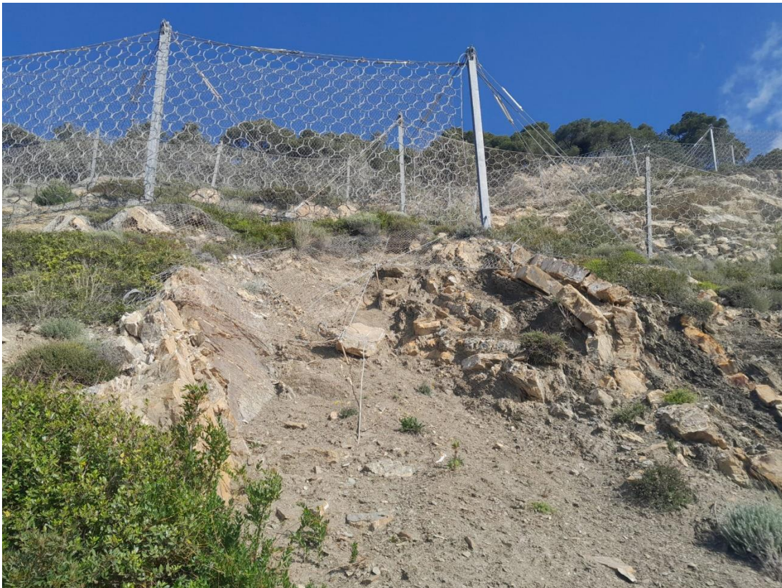
Figura 2 – rete in aderenza al versante in avanzato stato di ammaloramento e con diffusi fenomeni di franamento al piede
