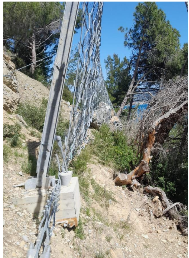
Figura 3: Immagini fotografiche della barriera paramassi BP.II.9, con evidenza delle criticità descritte nel testo
