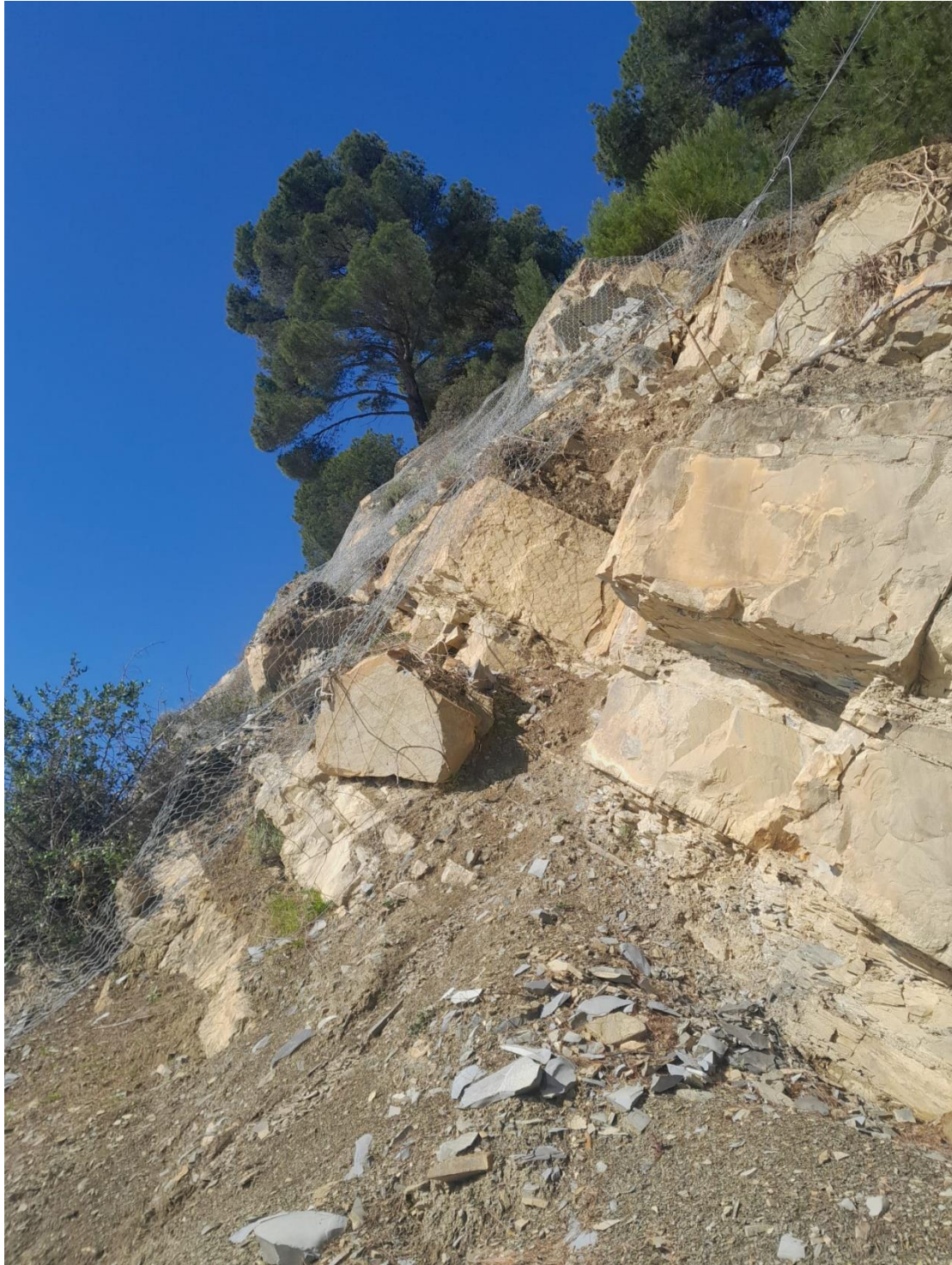
Figura 4: Immagini fotografiche dell'intervento di consolidamento corticale RC.DM.12, con evidenza delle criticità descritte nel testo
